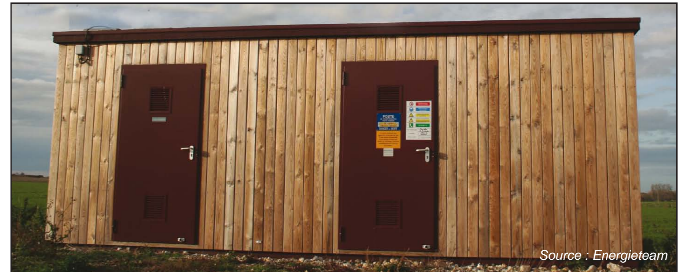
Figure 17 : Exemple type de poste de livraison.
